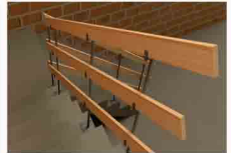
PROTEÇÃO PARA ESCADA
