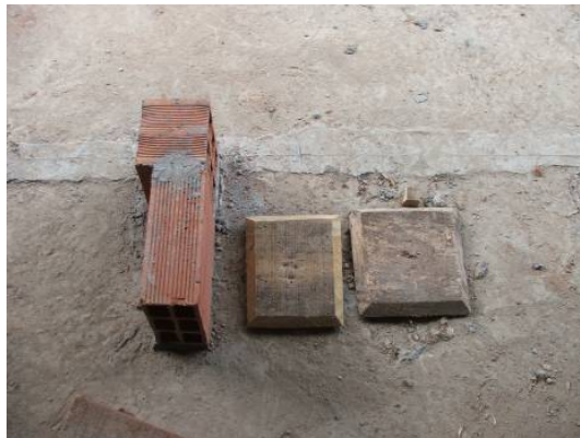
Figura 23: Tampas fechando aberturas na laje. Fonte: SESI – BA
