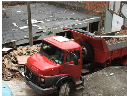
Figura 19: Estoque de sobras de madeira em obra. Fonte: SESI – BA
