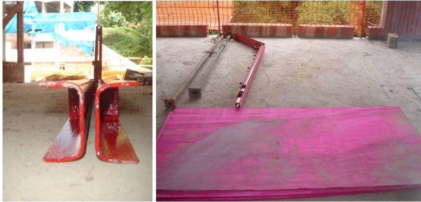
Figura 8: Detalhe do novo perfil metálico (à esquerda) e perfil, escora e chapa compensada (à direita). Fonte: SESI – BA
