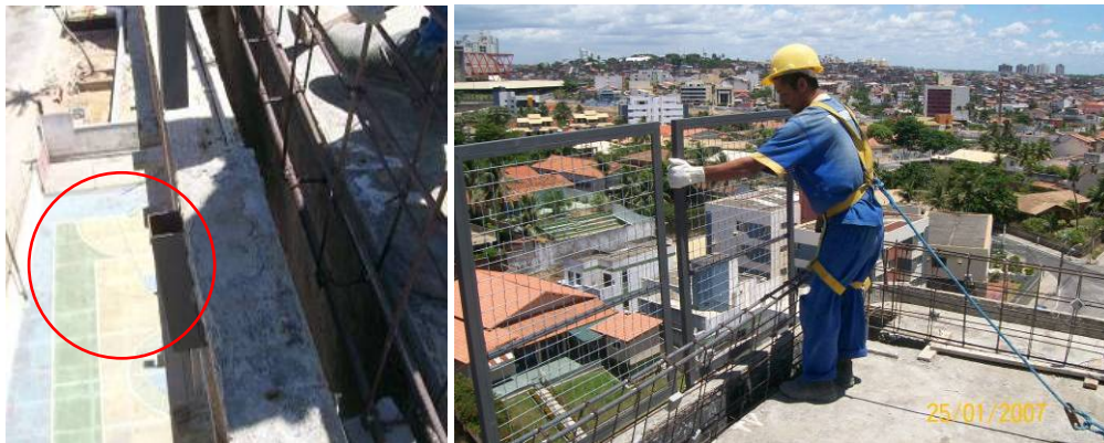
Figura 30: Posição da peça de suporte (à esquerda) e a colocação do guarda-corpo (à direita). Fonte: SESI – BA
