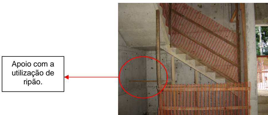
Figura 45: Detalhe mostrando a fixação dos barrotes no vão de escada. Fonte: SESI – BA
