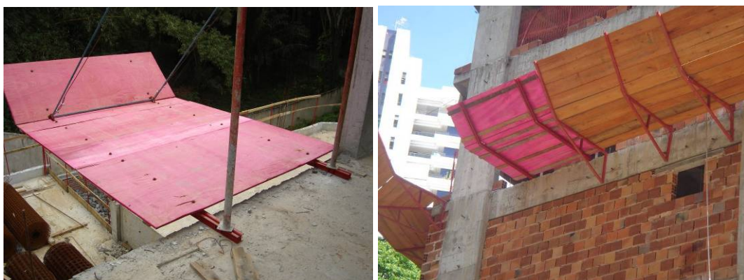
Figura15: Aspecto final da nova bandeja primária (à esquerda) e secundária (à direita). Fonte: SESI – BA
