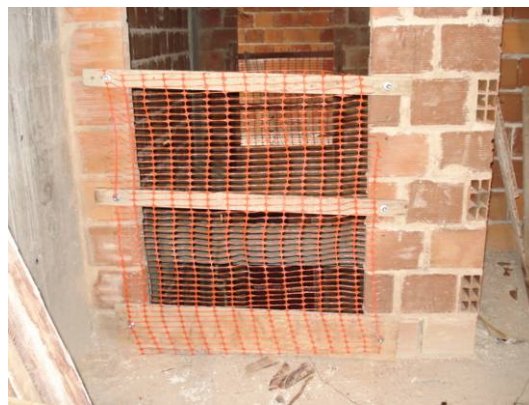
Figura 43: Segunda solução de guarda-corpo de poço de elevador. Fonte: SESI – BA
