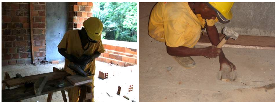
Figura 22: Operário fazendo uma tampa de fechamento de laje (à esquerda) e colocando um barrote na abertura da laje (à direita). Fonte: SESI – BA
